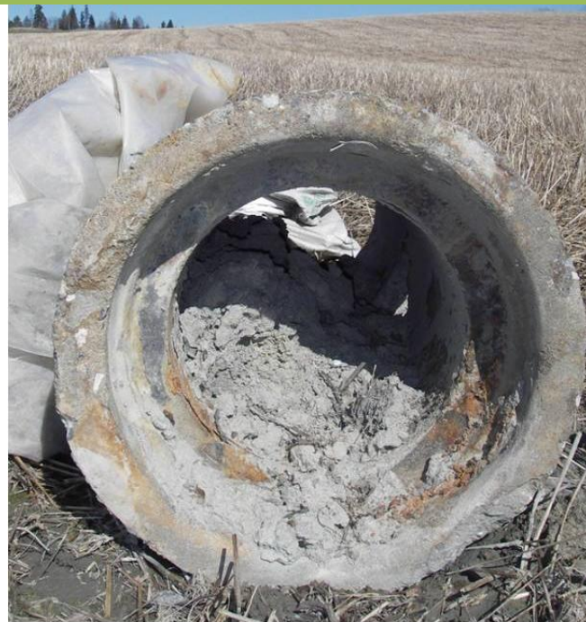
Økte flomtopper krever større rørdimensjoner. (Foto: Atle Hauge)
